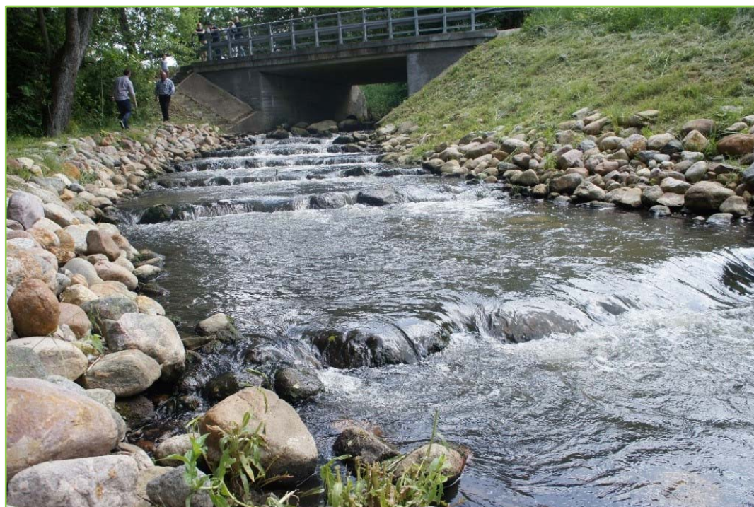
Vzdouvací stupeň ve vsi Pomieň na řece Stobnica, ř. km 2 + 630 – stav po výstavbě rybího přechodu
