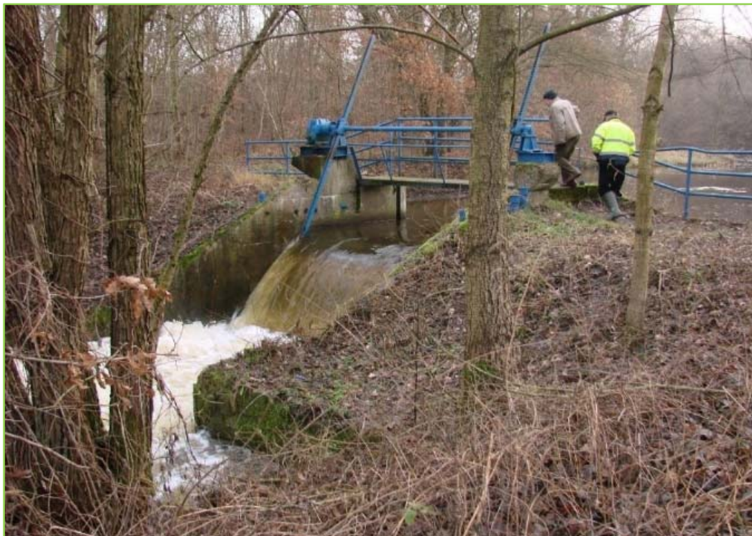
Klapkový jez na řece Křepa, ř. km 1 + 100 – stav před stavbou rybího přechodu
