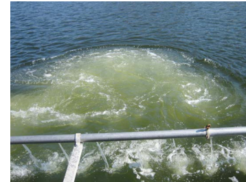
Drażki do dozowania substancji, wprowadzanie czynnika strącającego Źródło: Mathes, LU M-V
