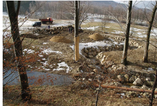
W trakcie realizacji prac Źródło: Archivum Správa CHKO Jizerské hory (Zarząd Obszaru Chronionego Krajobrazu Góry Izerskie)
