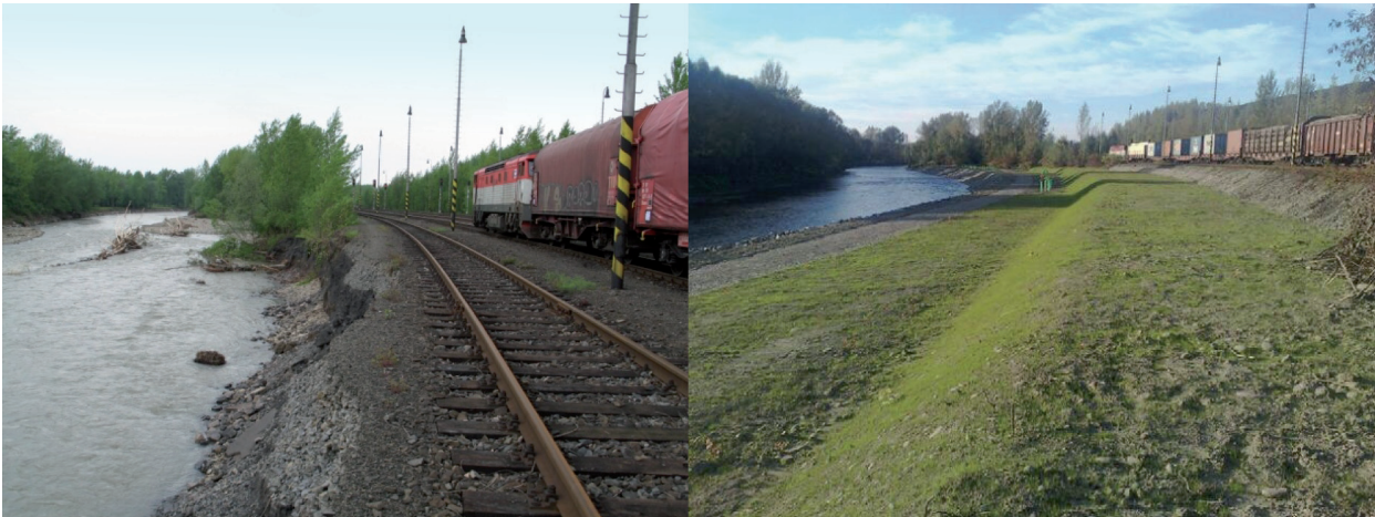
Abbildung 1: Uferbruch – Fluss Ostravice in Paskov, Länge ca. 600 m, Breite ca. 40 m unmittelbar nach dem Hochwasser im Mai und nach der Sanierung im September 2010
