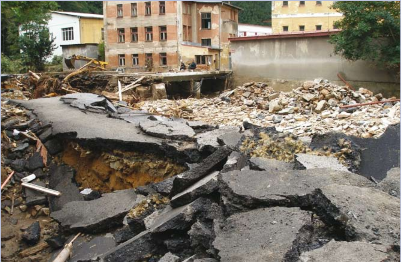
Obr. 11: Škody způsobené na řece Smědě ve Frýdlantu (Foto: Povodí Labe, státní podnik dne 13.8.2010)
